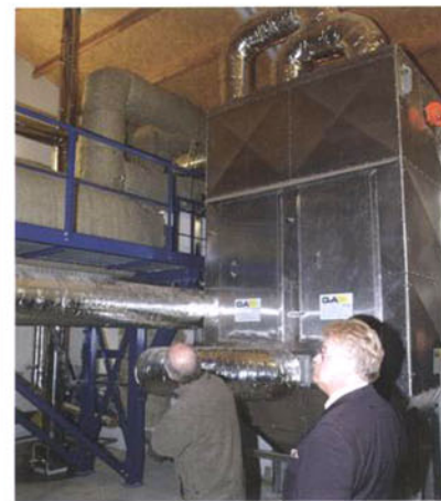
In diesem Behälter befinden sich die Filter.
