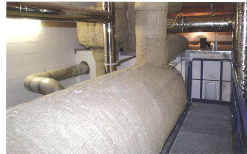
Alle Bauteile sind sehr gut isoliert, hier ist der Hauptreaktor zu sehen.
